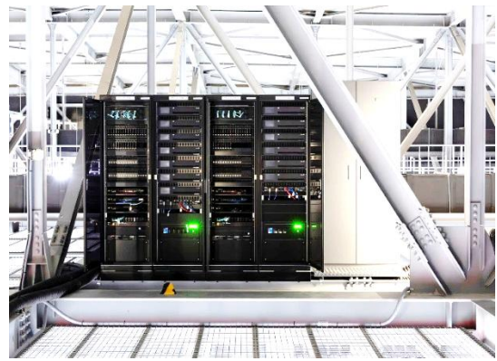
天井裏のシステム
