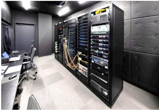
コントロールルーム①
