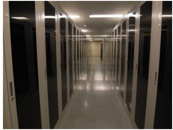
大阪 IDC（内観）
